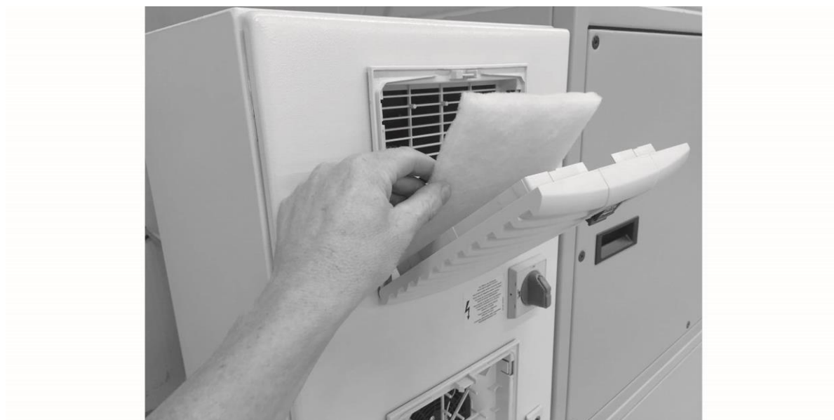
Fig. 39: Cambio del filtro del armario de distribución
