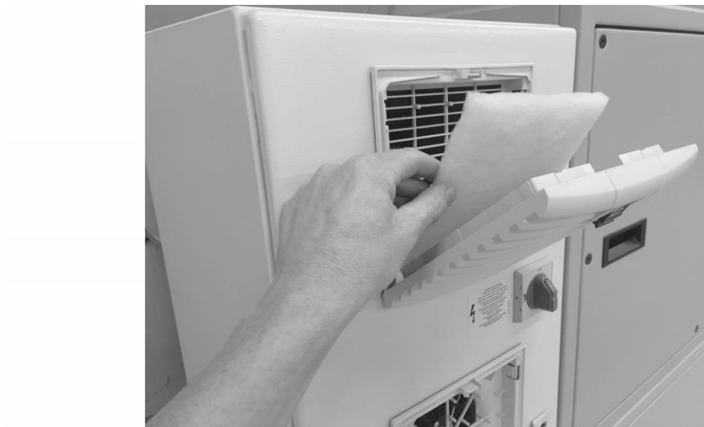
Rys. 130: Wymiana filtra szafy sterowniczej
